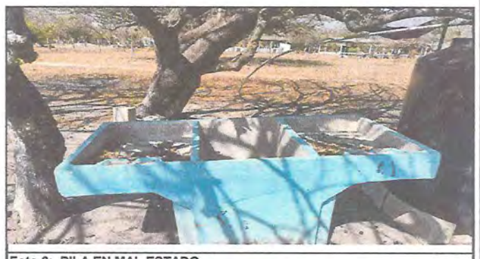
Foto 6: PILA EN MAL ESTADO
